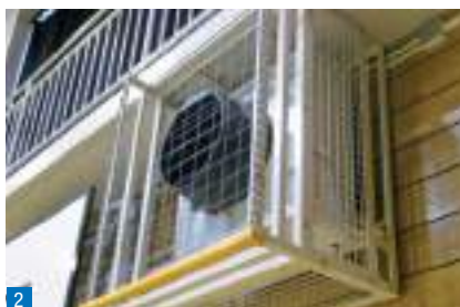
キャットウォーク下に吊下げ設置
