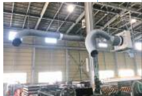
吹き出し口にダクトの設置が可能
