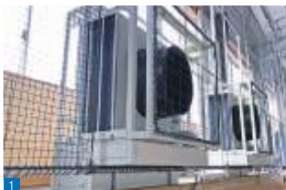
キャットウォーク上に床置き設置
